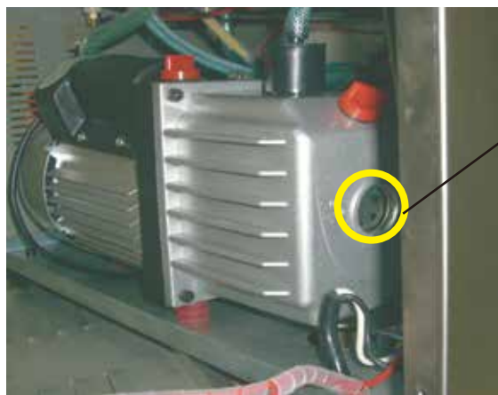
ポンプのオイル窓
